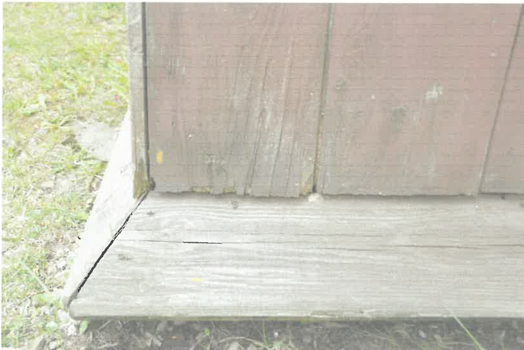
Fot. 6 Daszek zabezpieczający podwalinę drewnianą. Drewno wyjąłowione, wyszarzone. Końcówki desek szalowania zbutwiałe.
