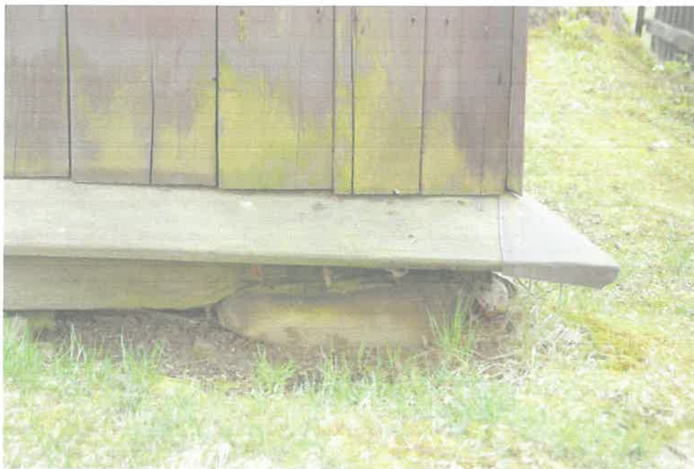
Fot. 7 Drewniana podwalina.
