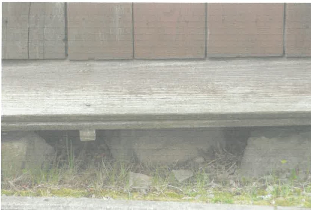
Fot. 1 Kamienna podmurówka. Widoczne zazielenienia, powierzchnia kamienia pokryta mchami i porostami.
