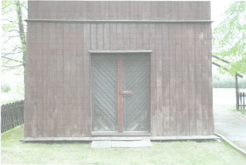
Fot. 12 Drzwi na elewacji zachodniej. Widoczne ubytki w powłoce lakierniczej.
