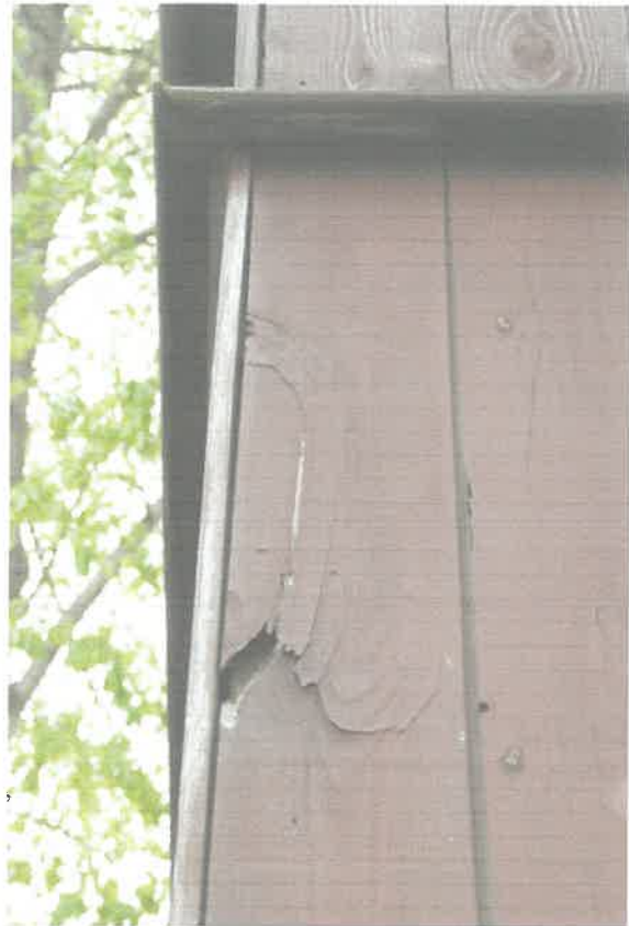
Fot. 5 Ubytki w poszyciu elewacji
