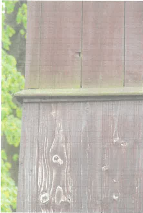
Fot. 4 Deska stanowiąca gzyms elewacyjny.
