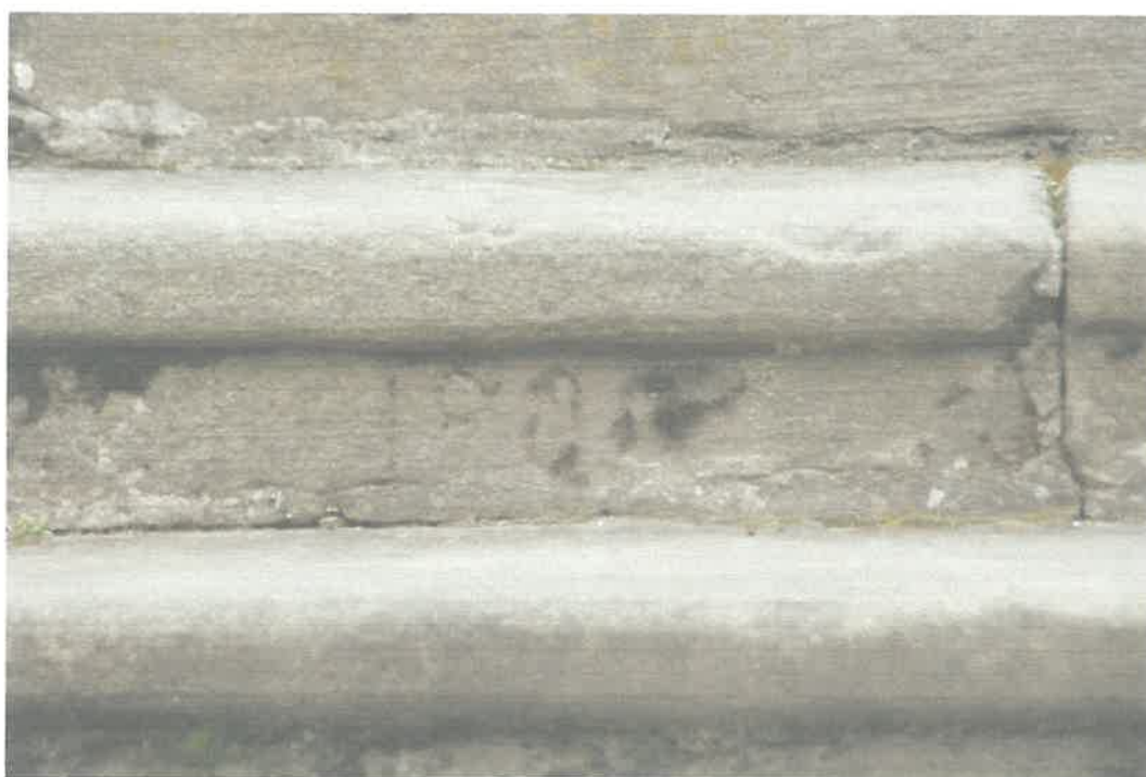
Fot. 5 Schody zewnętrzne przed głównym wejściem do budynku. Widoczny napis z datą wryty w podstopnicy. Powierzchnia kamienia popękana, miejscami zazieleniona.
