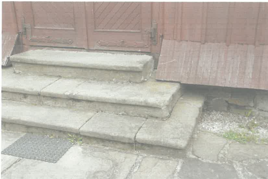
Fot. 6 Schody zewnętrzne przed głównym wejściem do budynku. Widoczne rozspojenia poszczególnych bloków uzupełniane cementem
