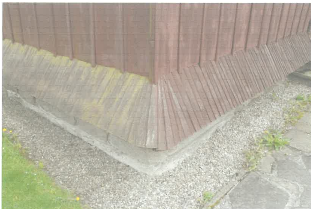
Fot. 8 Daszek zabezpieczający podwalinę drewnianą – od strony północnej widoczne silne zazielenienie, całość pokryta farbą olejną.
