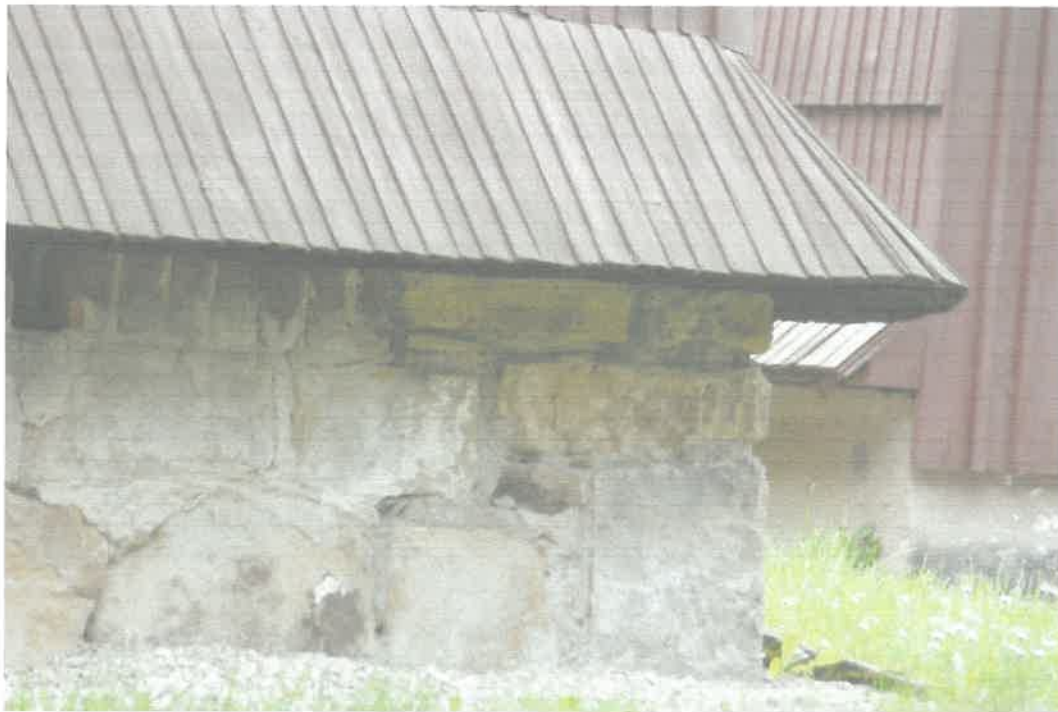
Fot. 3 Kamienna podmurówka – uzupełnienia z cegieł.
