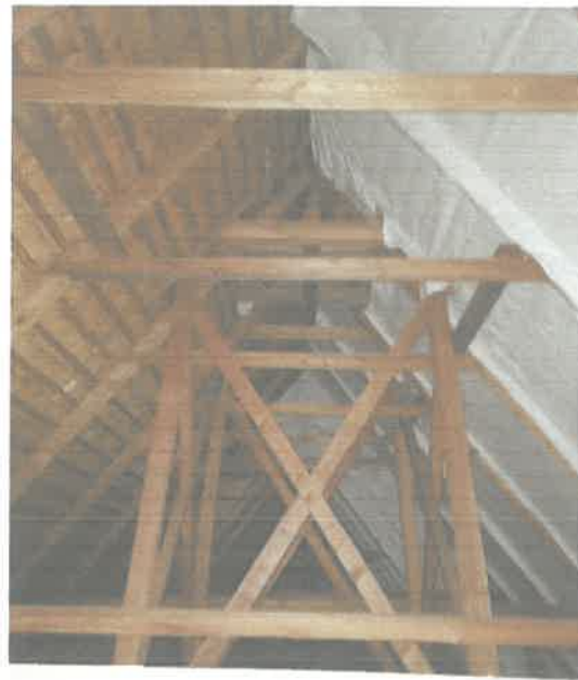
Fot. 12 Dach nad nawą główną. Połacie południowa zabezpieczona prowizorycznie folią
