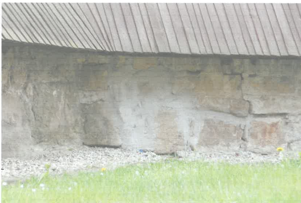
Fot. 2 Wtórne uzupełnienia zaprawy w kamiennej podmurówce.
