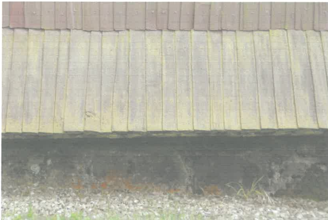
Fot. 1 Kamienna podmurówka – strona północna. Widoczne zazielenienia, powierzchnia kamienia pokryta mchami i porostami.
